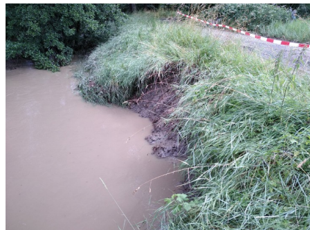
BOUZEL Le Jauron - Erosion de berge 2021
